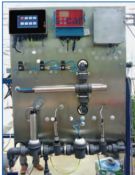
Station de mesure
