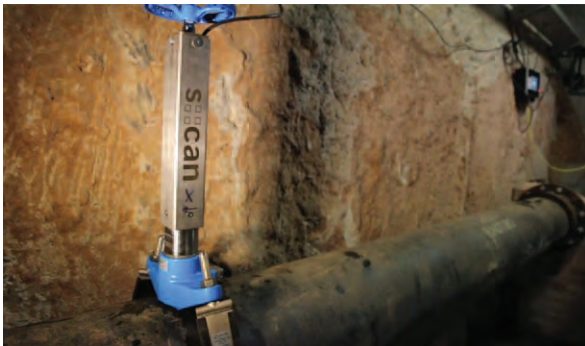
i::scan installé dans une conduite
