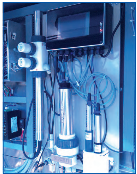
Station de mesure
