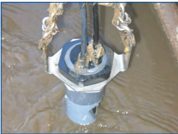
oxi::lyser en bassin d'aération
