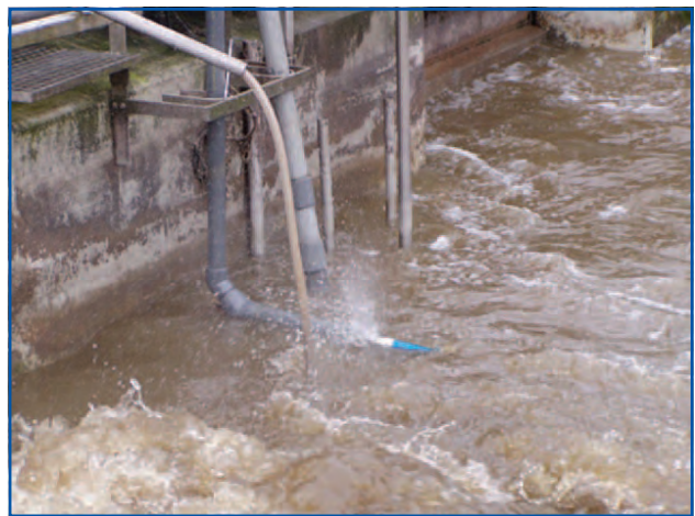
spectro::lyser en bassin d'aération
